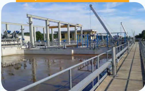
Depuratore di Montichiari
